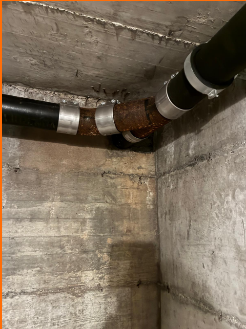
Unisolierte Meteor- abwasserleitungen
